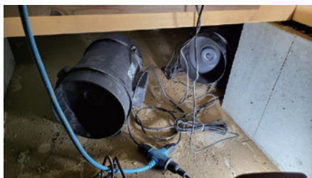
図-6 ダクトファン
