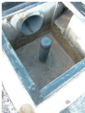
(i) 既存雨水ますに設置された 縦型雨水浸透施設
