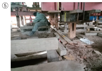
⑤ 揚家途中 (腐食した土台が自然に脱落)
