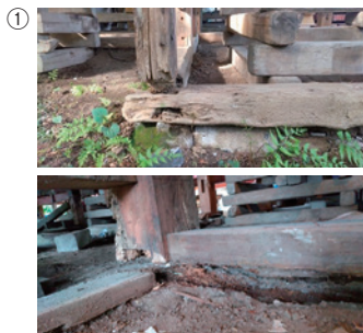
① 石場建てで腐食した土台
