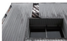
すでに外壁が飛散する危険性等が増大
