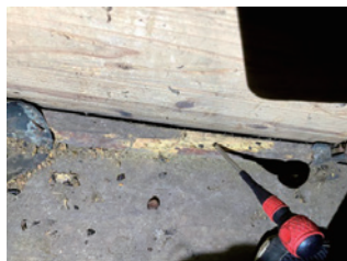
蟻害による床の劣化
