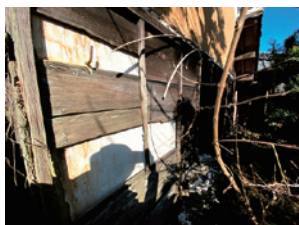
外壁板壁の劣化
