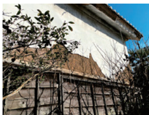
外壁 漆喰剥離と板壁の劣化
