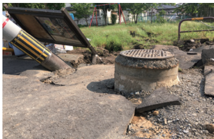
写真-23 液状化被害
