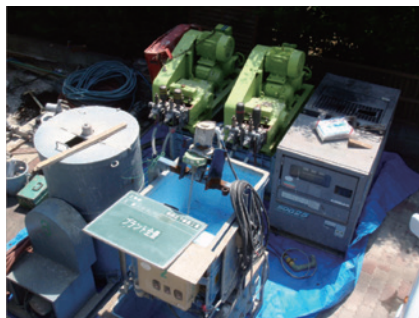
定置プラントの例
