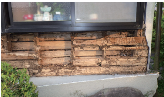
写真-8 蟻害を受けた木造住宅
