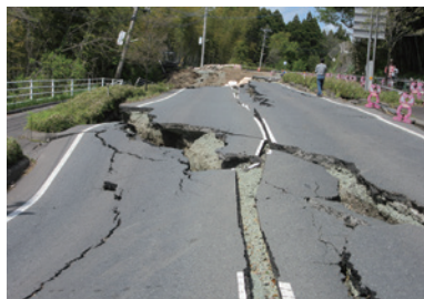
写真-2 道路面の地盤崩壊
