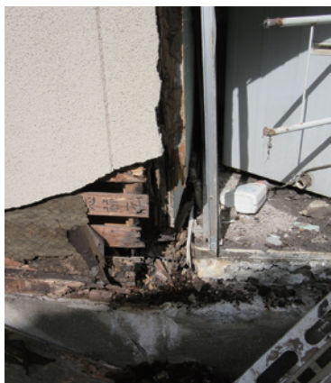
写真-7 腐朽した木造住宅
