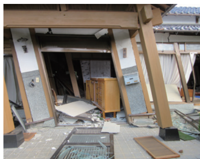
写真-11 和風建築で壁量不足と思われる被害
