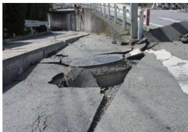
写真-3 液状化による地盤崩壊
