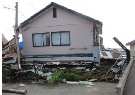
写真-5 土留ブロック崩壊により1階崩壊
