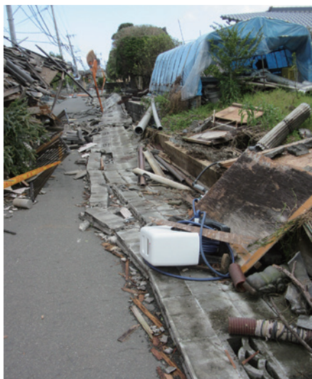
写真-21 倒壊したブロック塀
