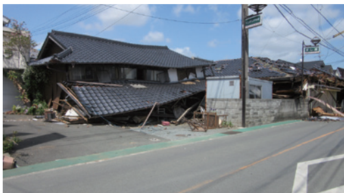
写真-12 南面が壁量不足と思われる和風住宅
