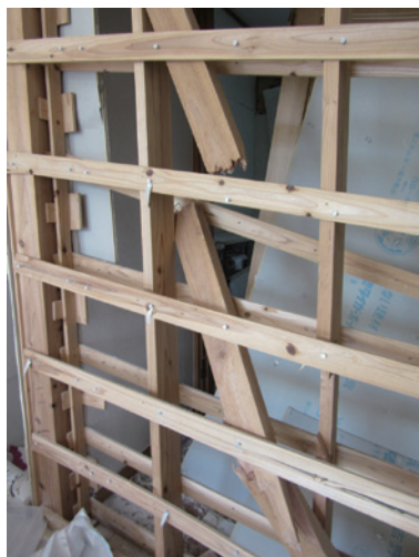
写真-17 破断した筋かい
