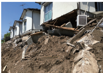
写真-6 擁壁崩壊
