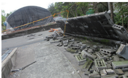
写真-22 倒壊したブロック塀
