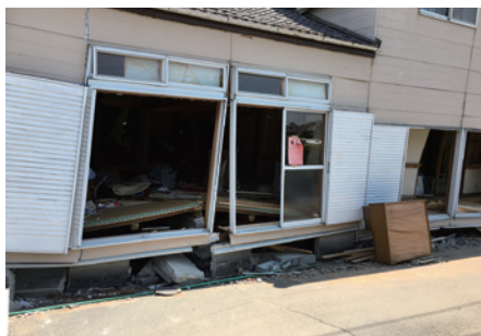
写真-19 建物の基礎に使用されたブロック
