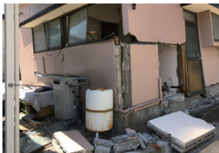
写真-20 浴室腰壁に使用されたブロック
