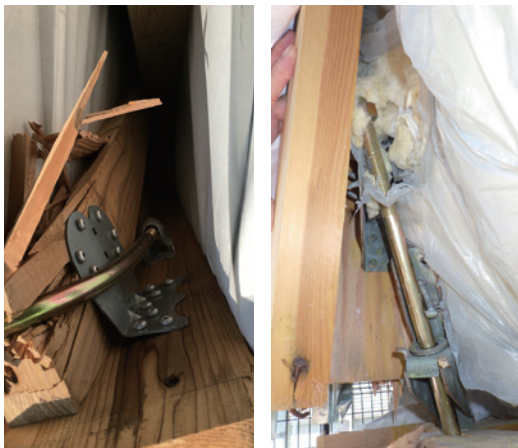
写真-18 ホールダウン金物の破断
