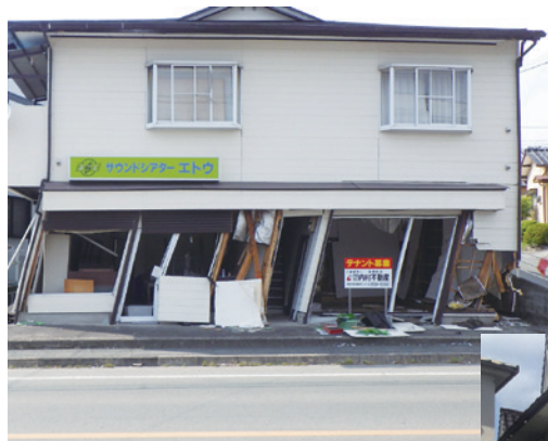
写真-9 1階に壁のない壁量不足の店舗
