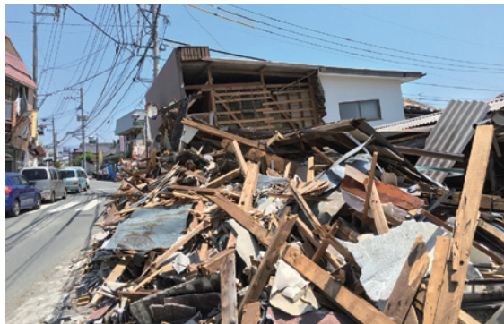
写真-24 街道沿いの店舗被害
