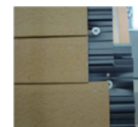
タイルがずれても剥落、脱落なし
