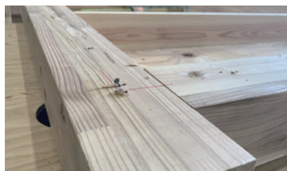
耐震等級2の試験体で見られた変形した釘
